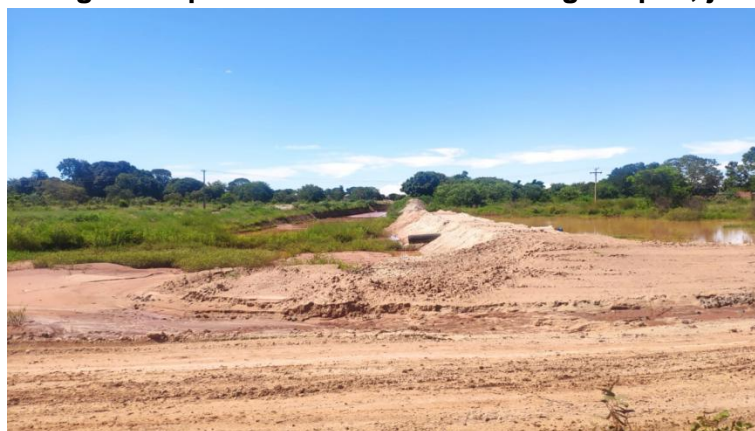
Figura 5.3- 3 Imagem do processo erosivo no Córrego Japão, junto à BR - 262
